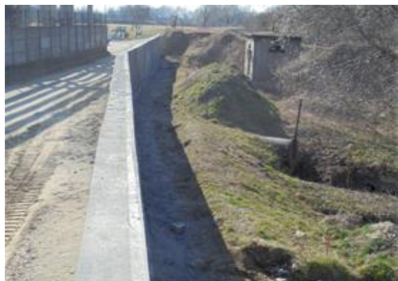
WYREMONTOWANY MUR OPOROWY PRZYCZÓŁKA WYLOTU PRZEPUSTU WAŁOWEGO NA PRAWYM WALE W KM 0+600
